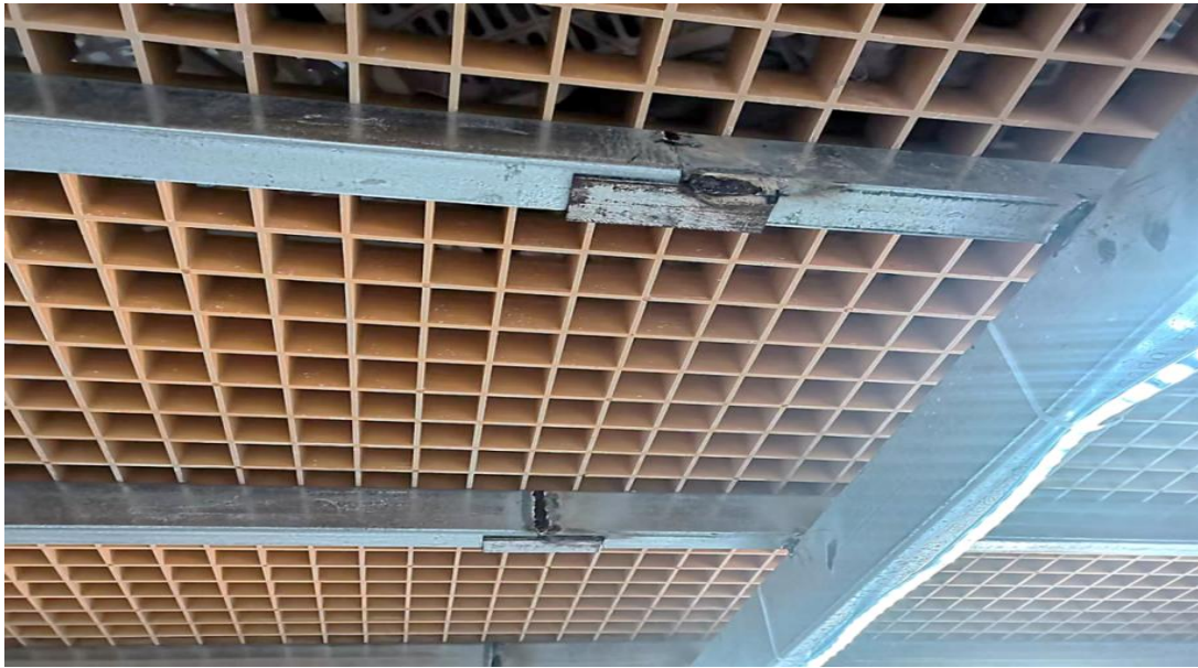
图 5 6号保鲜库次梁焊缝情况
